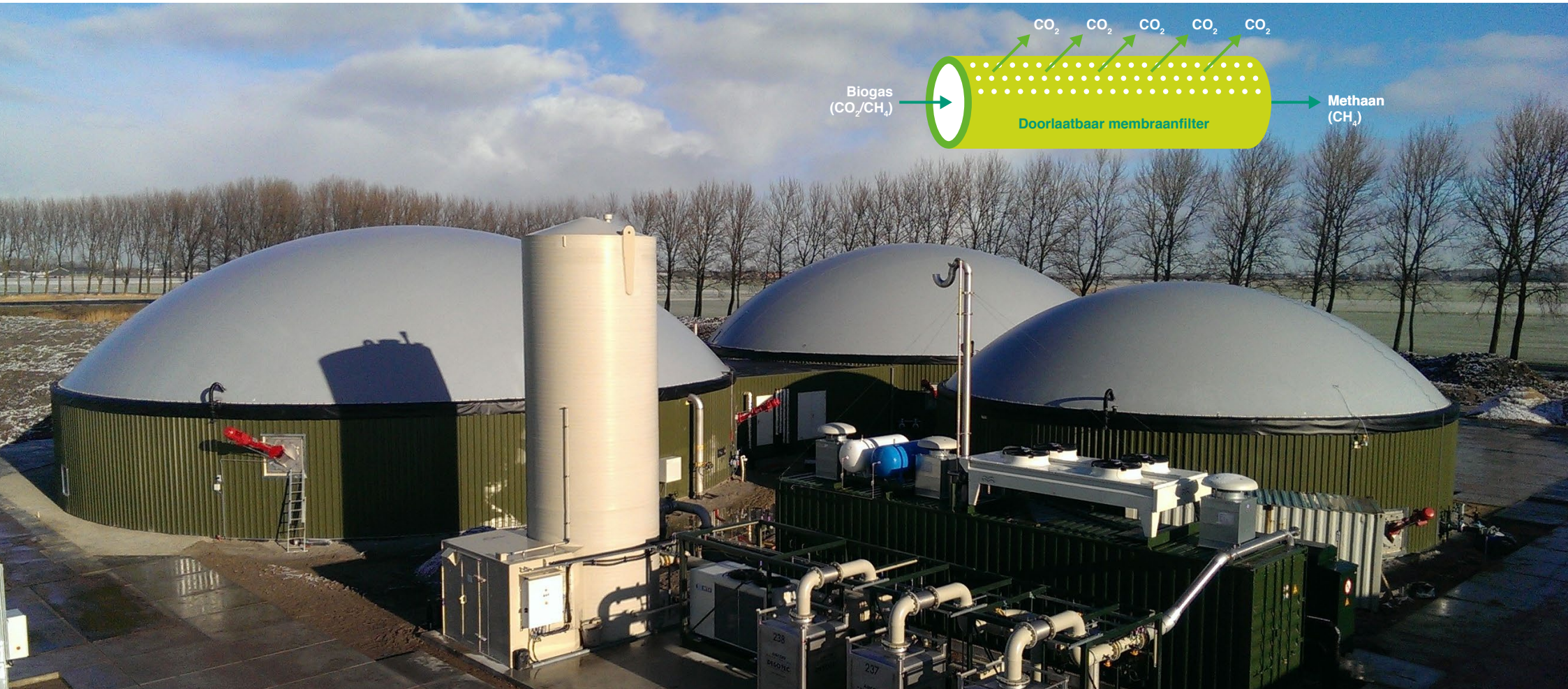
17 Vergister met membraaninstallatie
