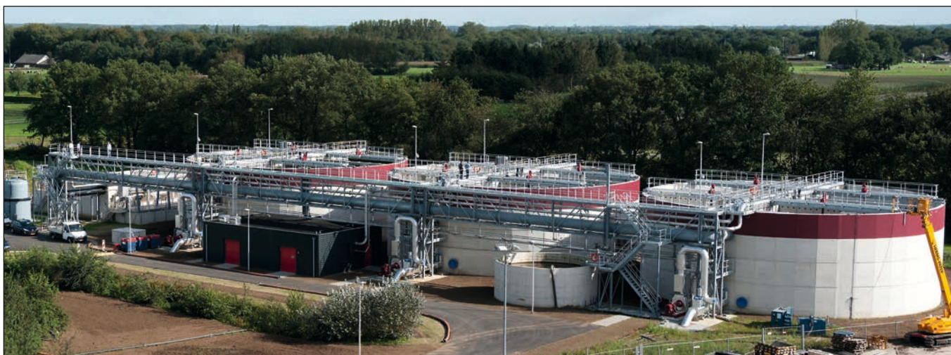
Figuur 19 Rioolwaterzuiveringsinstallatie in Epe. Bron: DHV
