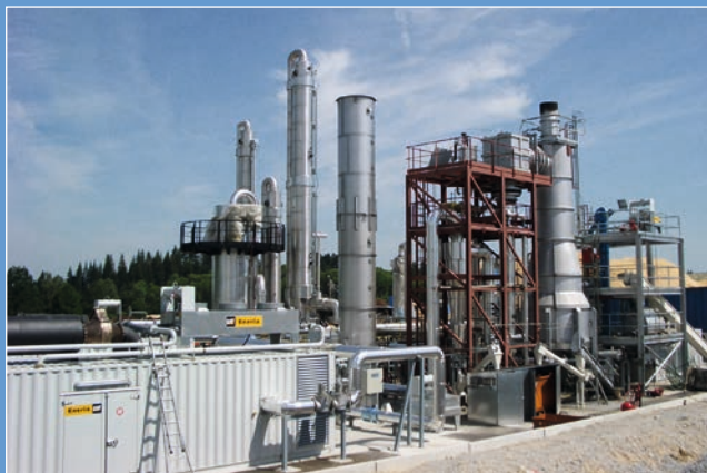
Figuur 9 Deze gasreinigungsstraat in het Franse Moissannes reinigt productgas van teer en stof. De hier afgebeelde OLGA-technologie is ontwikkeld bij ECN en is eigendom van Royal Dahlman. Bron: Dahlman Filter Technology
