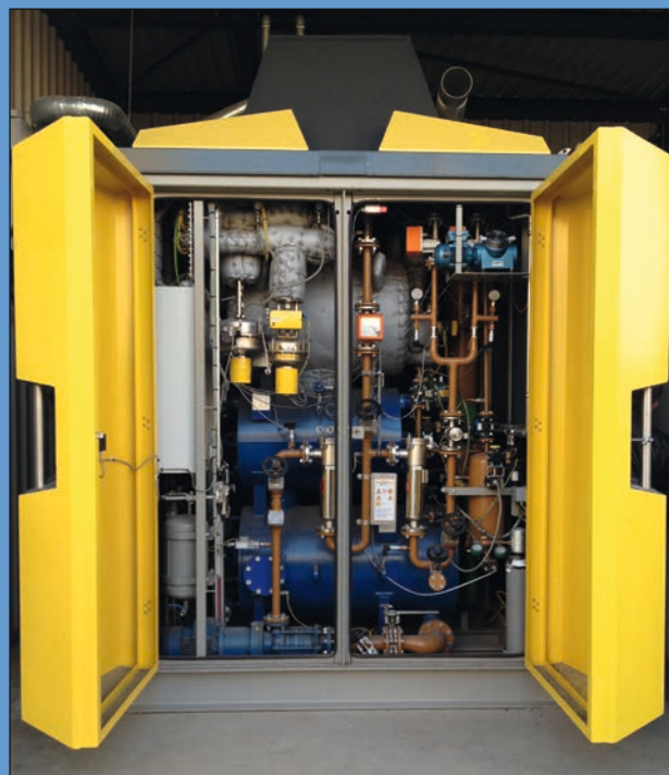
Figuur 10 ORC bij de biogasinstallatie van VAR in Wilp. Bron: VAR
