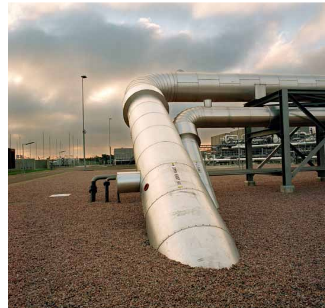
Foto pagina 175 In de jaren negentig bouwt de NAM bij Langelo en Grijskerk ondergrondse opslagplaatsen voor aardgas in lege gasvelden. Hier zijn gasbuizen op de locatie Langelo te zien.
