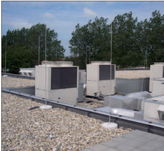
Figuur 14 Gasmotorwarmtepompen op het dak van bioscoop CineMagnus in Schagen (paragraaf 7.1). Bron: ICE
