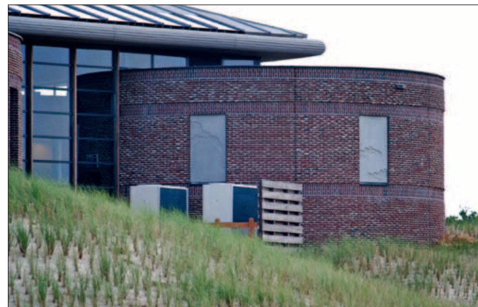
Figuur 16 Opstelling van twee gasmotorwarmtepompen naast het gebouw. Bron: BDH
