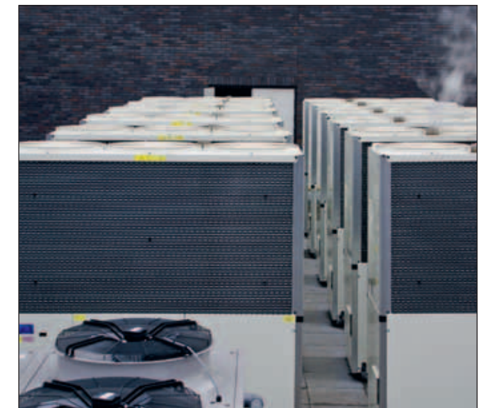
Figuur 15 Warmtepompen op het dak van een winkelcentrum in Geleen. Bron: Gasengineering
