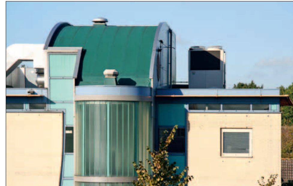
Figuur 3 Twee gasmotorwarmtepompen op het dak van de kliniek. Bron: BDH
