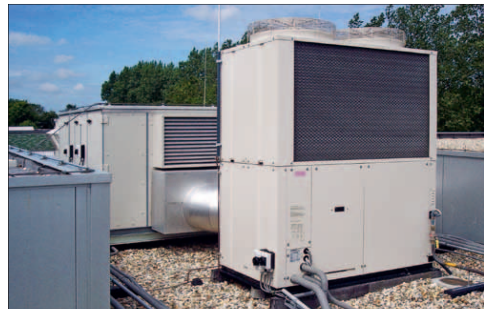
Figuur 2 Gasmotorwarmtepomp opgesteld op het dak. Bron: ICE
