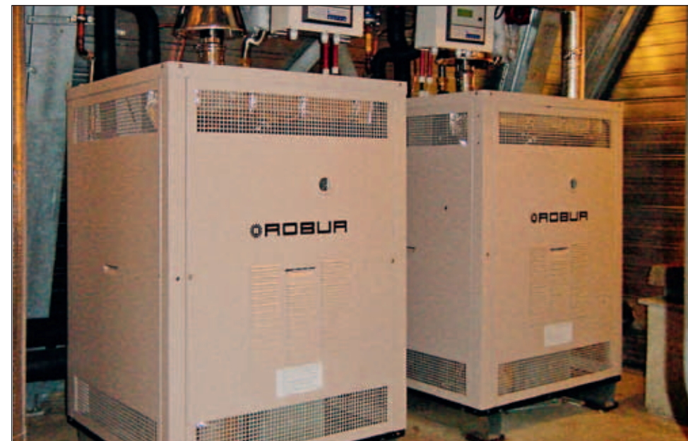
Figuur 8 Opstelling van twee van de zestien gasabsorptiewarmtepompen. Bron: Techneco
