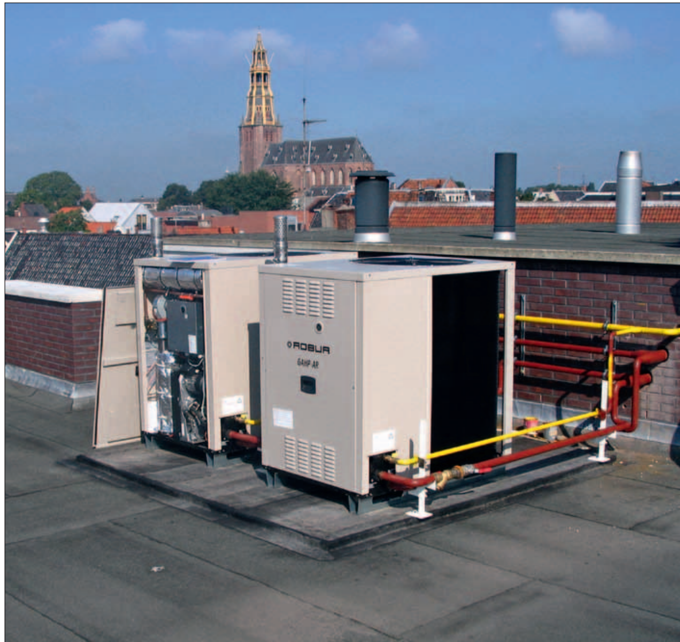
Figuur 26 Gasabsorptiewarmtepompen in bivalente opstelling met bestaande CV-ketels bij verzorgingstehuis Pelsterhof in Groningen. Bron: BDH
