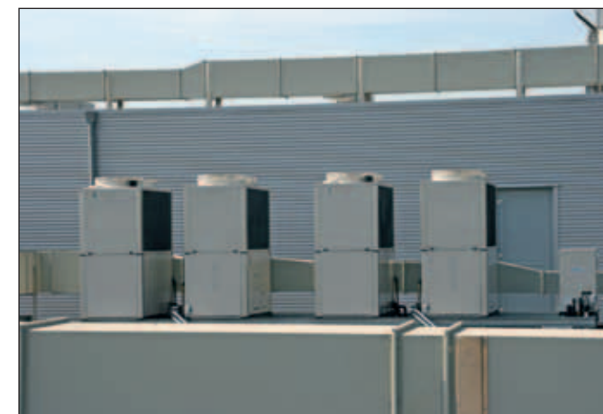
Figuur 11 Project met Sanyo gasmotorwarmtepompen in Raalte. Bron: ICE
