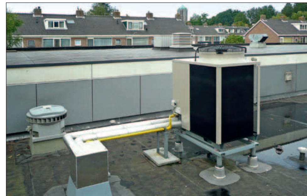
Figuur 10 Opstelling van de gasabsorptiewarmtepomp op het dak. Bron: Techneco
