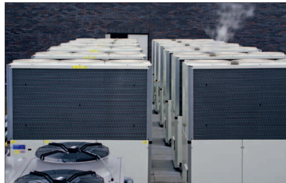
Figuur 14 Opstelling van de gasmotorwarmtepompen vanuit een ander gezichtspunt. Bron: Gasengineering
