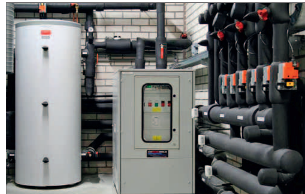
Figuur 18 Technische ruimte met hydromodule. Bron: Gasengineering
