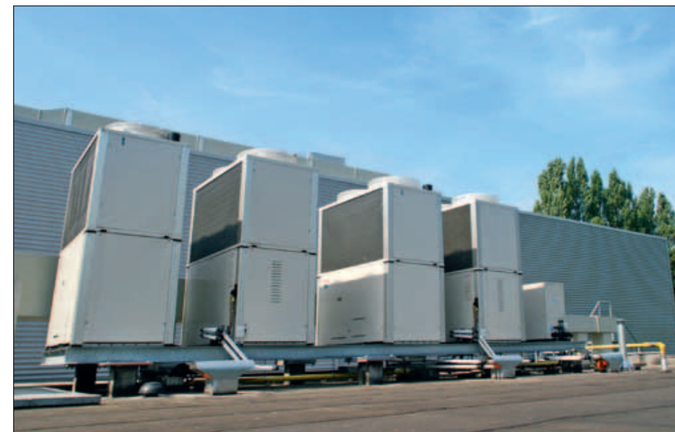
Figuur 6 Opstelling van vier gasmotorwarmtepompen op het dak. Bron: ICE
