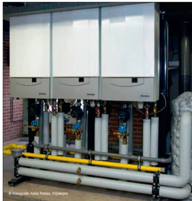
Figuur 6 Drie HR-wandketels in een cascadeopstelling. Bron: Anita Pantius
