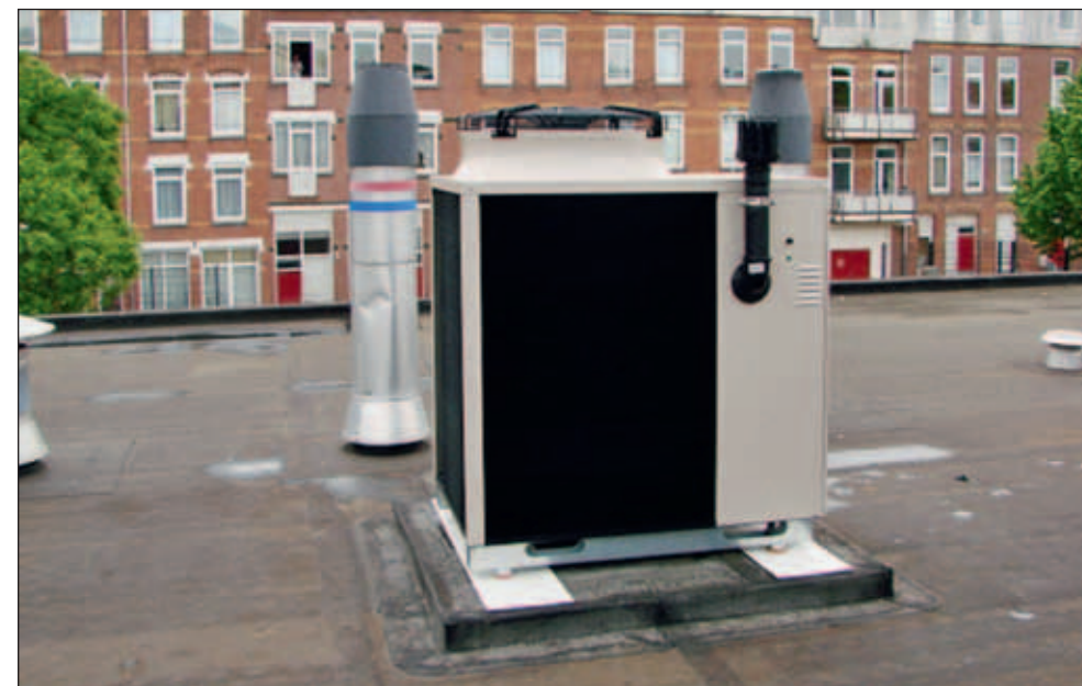
Figuur 12 Opstelling van de gasabsorptiewarmtepomp op het Sportfondsenbad in Rotterdam. Bron: Sportfondsen Nederland
