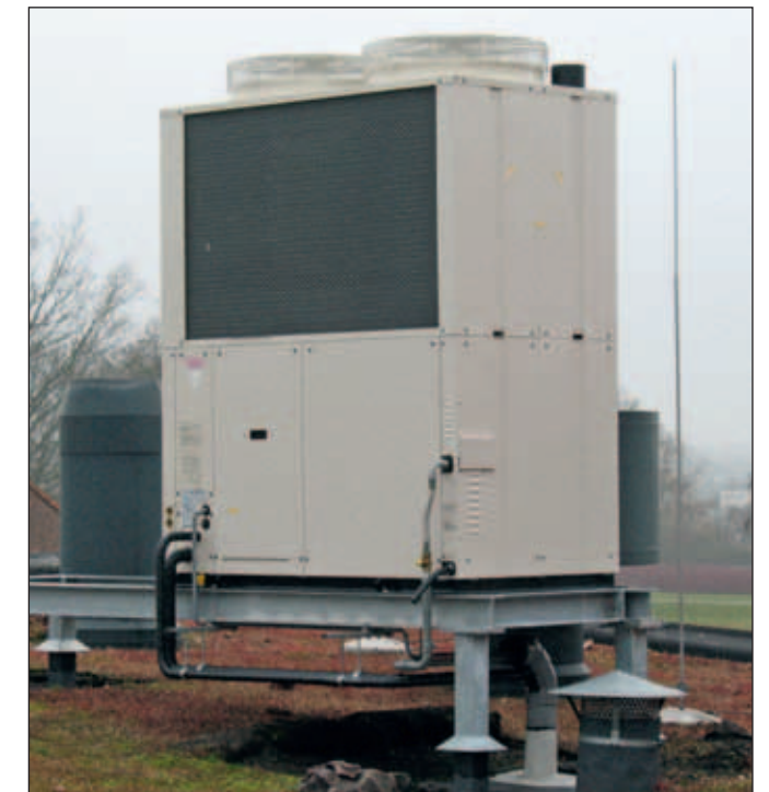
Figuur 12 Warmtepomproject bij zorginstelling Twckkelerveld. Bron: BDH
