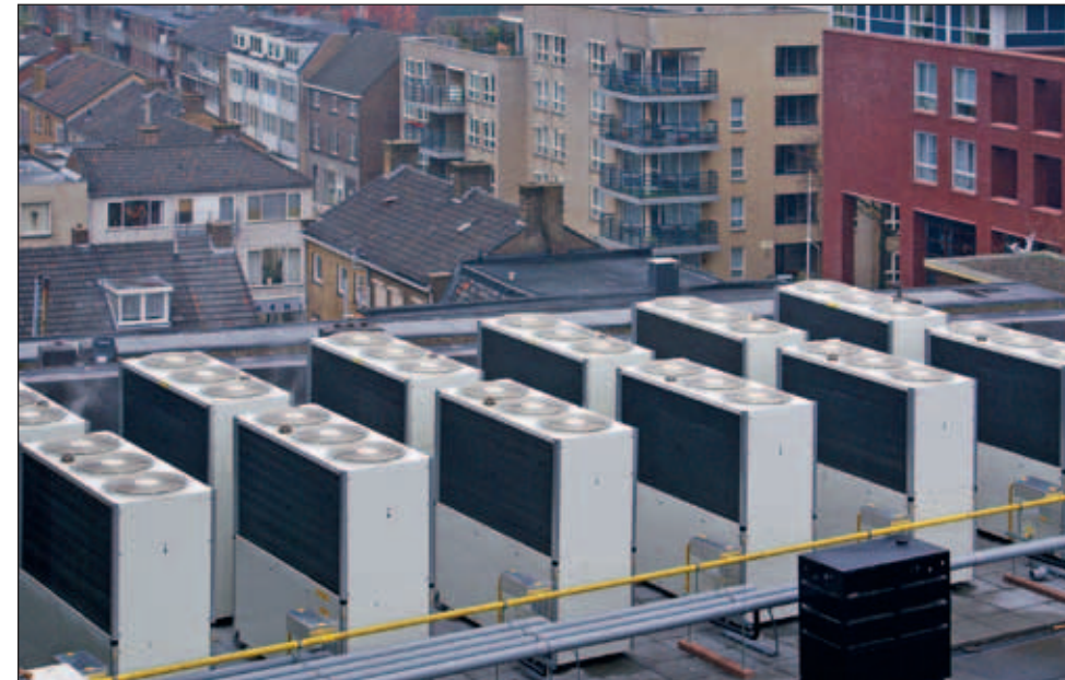
Figuur 13 Gasmotorwarmtepompen op het dak van het winkelcentrum in Geleen. Bron: Gasengineering
