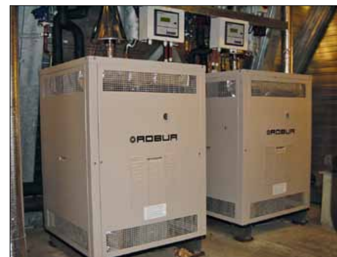
Figuur 6 Opstelling van twee van de zestien gasabsorptiewarmtepompen. Bron: Techneco
