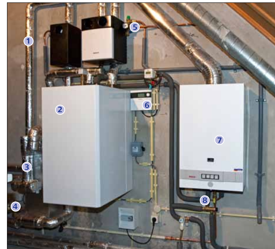
Figuur 10 De installaties in de woning. De boiler van 110 liter (links) en de geiser (rechts) zorgen voor warm water. Voor verwarming is per blok een centrale HR-ketel opgesteld. Bron: Nefit
