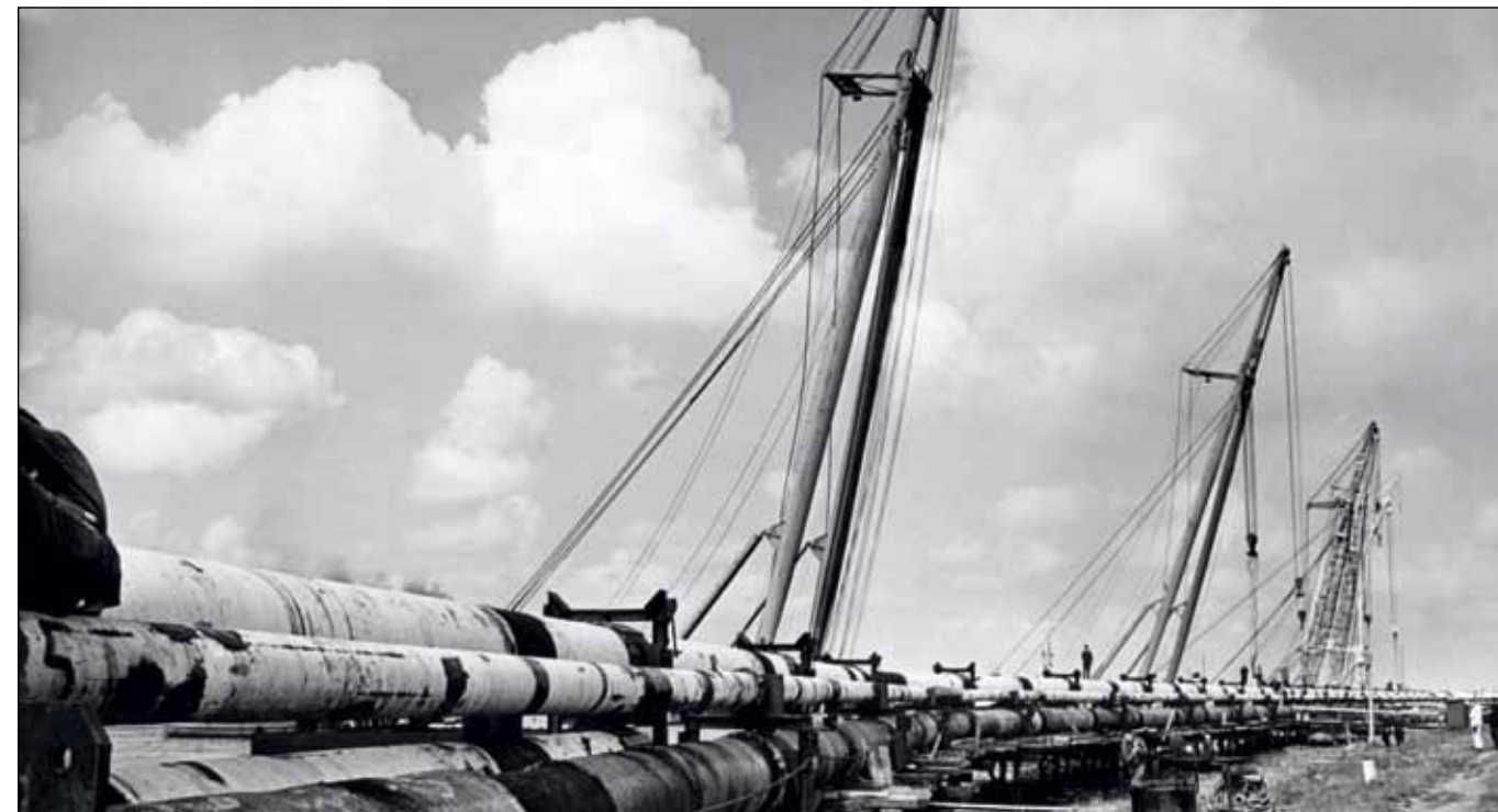
Figuur 10 Negen drijvende bokken moesten eraan te pas komen, om in augustus 1964 de aardgasleiding in de omgeving van de Velsertunnel aan te leggen. Foto: Nationaal Archief/Spaarnestad Photo/ANP/A. vanden Heuvel
