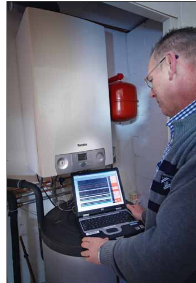
Figuur 8 Aan een correcte installatie van de micro-wkk's is veel aandacht besteed.
