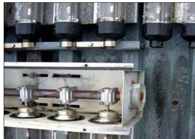
Figuur 9 Het oude systeem was aangetast door corrosie en aan vervanging toe. Bron: Nefit
