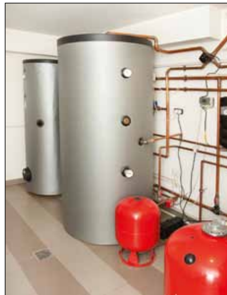
Figuur 7 Boiler vat voor de opslag van warm water. Foto: Shutterstock
