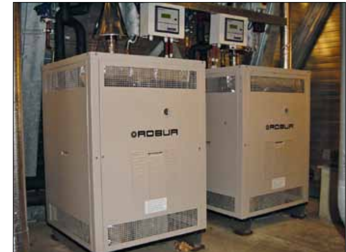
Figuur 4 Gasabsorptiewarmtepompen in cascadeopstelling. Foto: Techneco
